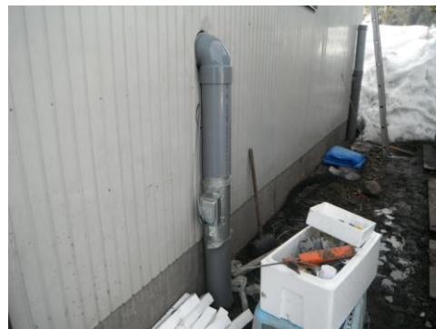
雪冷房利用に向けて冷熱を引込む
