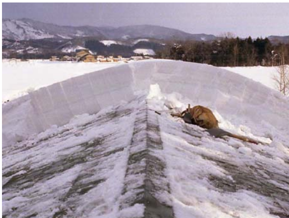
頂部(棟)の屋根雪
