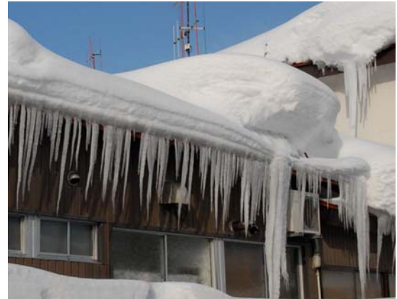
つららの発生状況
