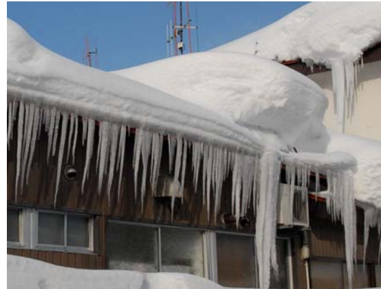
図IV-11 つららの発生状況
