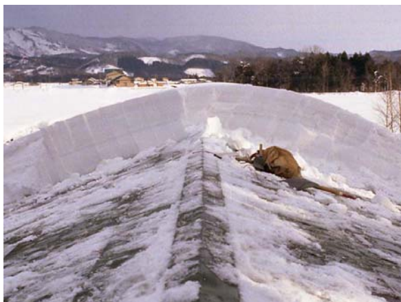
図Ⅱ-10 頂部(棟)の屋根雪
