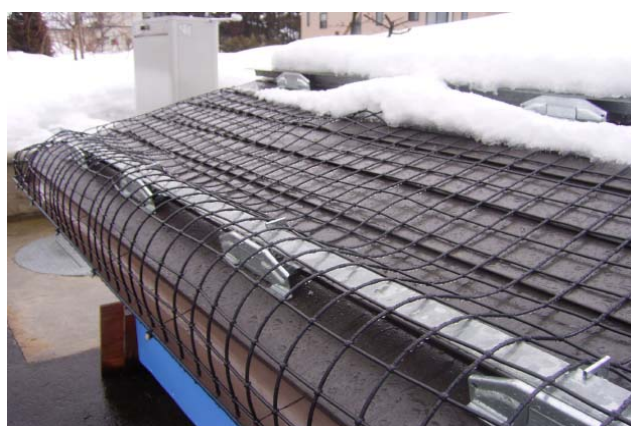
図Ⅱ-19 融雪装置を軒先の部分にのみ設置
