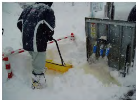
尾花沢市役所に設置された融雪槽
