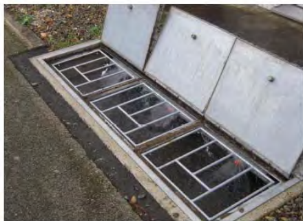
榎岡地区市民センターに設置された融雪槽
