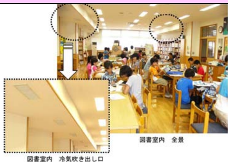
図書室内 冷風吹き出し口
